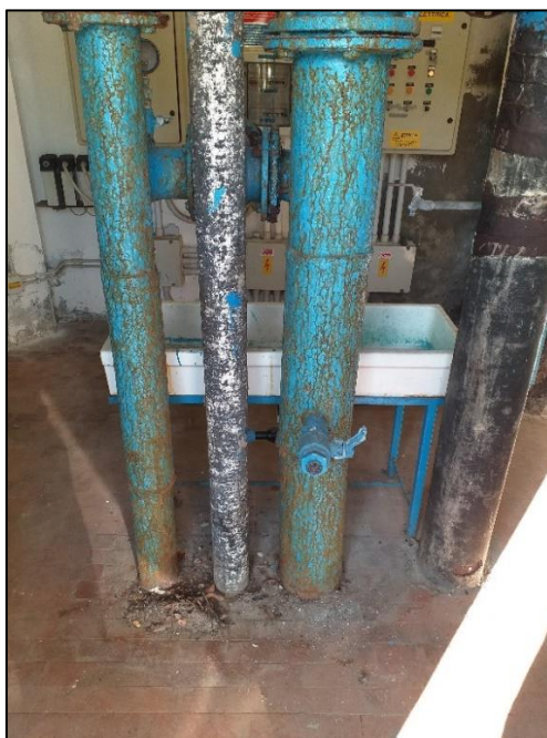
Fig.5: Condotta di uscita dalla centrale di potabilizzazione di Via Giordano Bruno
